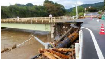
導水管が水害で破損したものの
